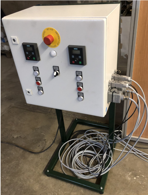
Bild 13 Steuereinheit der Bohranlage
