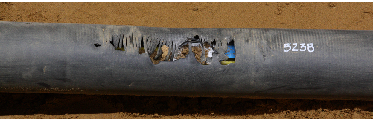
Bild 60 freigelegte beschädigte Ummantelung des alten ausgebohrten KMR
