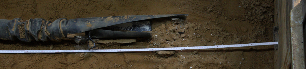
Bild 87 Bereich des Zugweges, Sand im Bereich des Seils des Seilzug-Wegsensors entfernt
