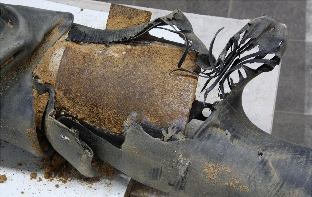
Bild 90 aufgefalteter, beim Ausbohren teilweise zerstörter Bereich der Ummantelung vor dem neuen Schlitz- und Aufweitkopf, im Graben unten gelegen
