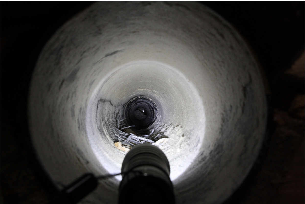
Bild 74 Blick in die ausgebohrte Ummantelung des alten KMR
