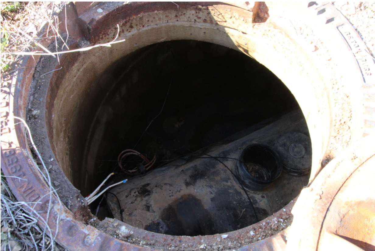
Bild 69 Messschacht, darin Doppelrohr KMR DN 100+DN 100/355
