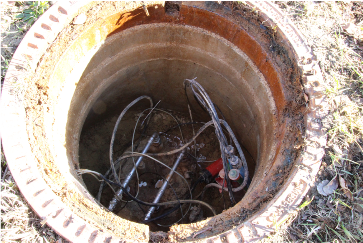
Bild 75 Messschacht, darin Doppelarmatur für Doppelrohr KMR DN 80+DN 80/355
