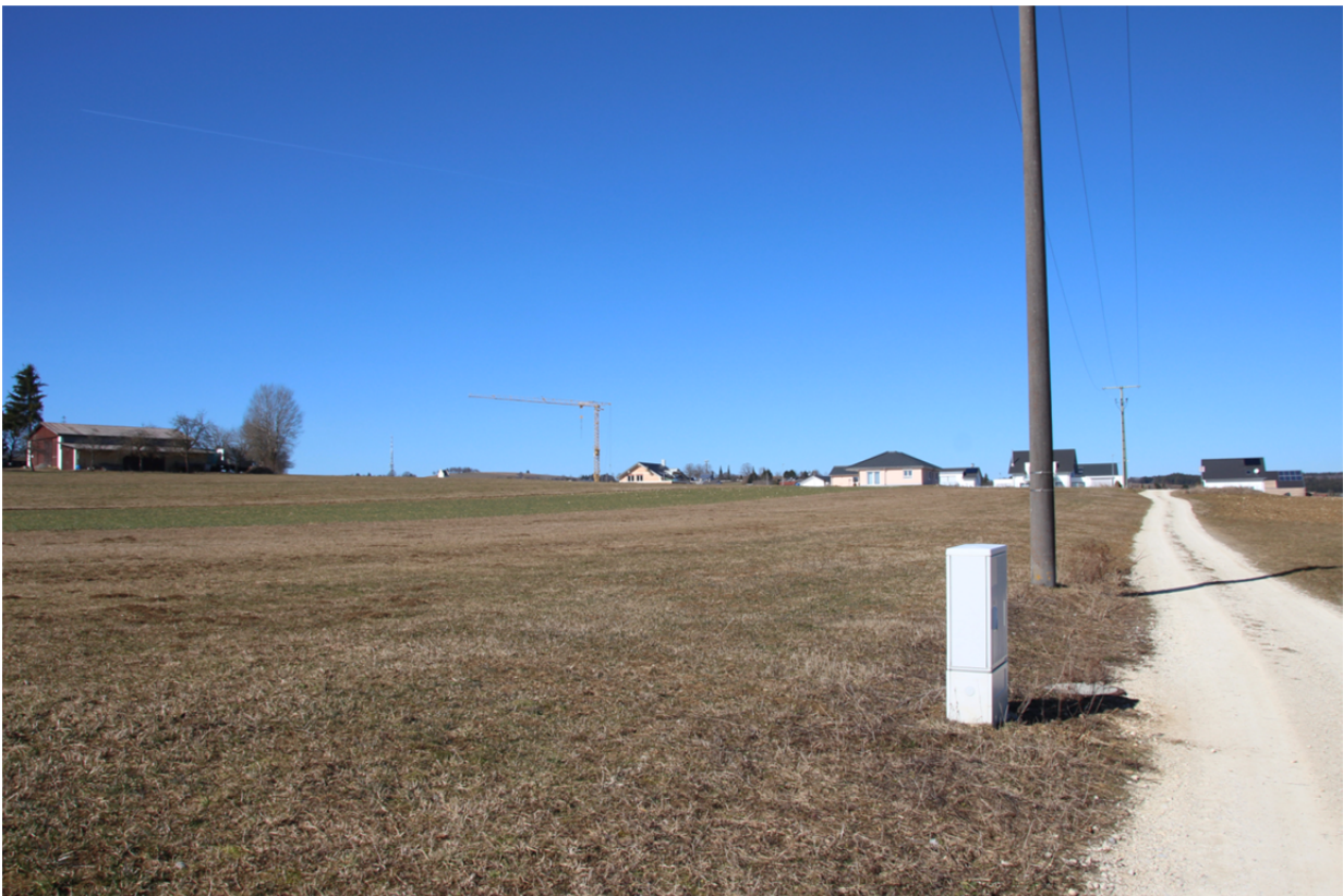
Bild 67 Schrank für Messtechnik, Messschacht, im Hintergrund Emmingen
