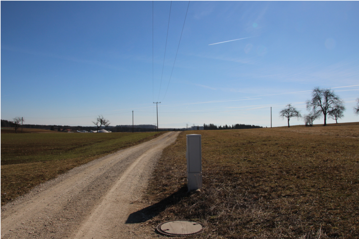
Bild 65 Messschacht, Schrank für Messtechnik, im Hintergrund speisendes Biomasse-Blockheizkraftwerk
